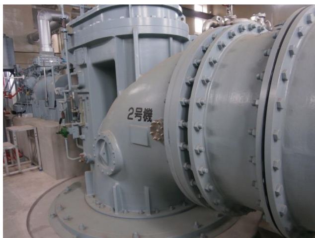
巨大な排水ポンプ（3基設置されている）
